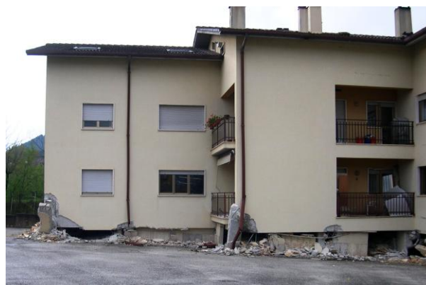
Figura 11. Collasso del piano terreno.
