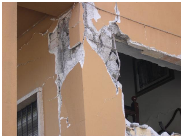
Figura 12. Dettagli costruttivi carenti.
