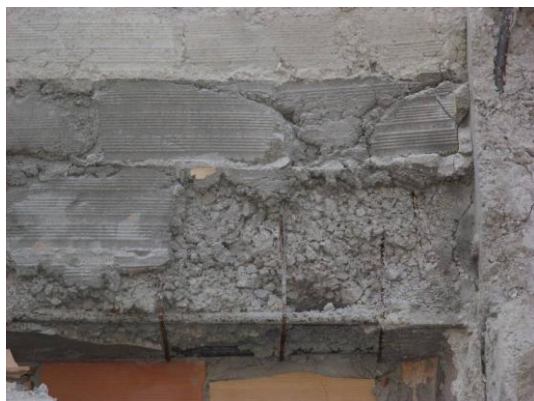
Figura 16. Segregazione degli inerti nel calcestruzzo.
