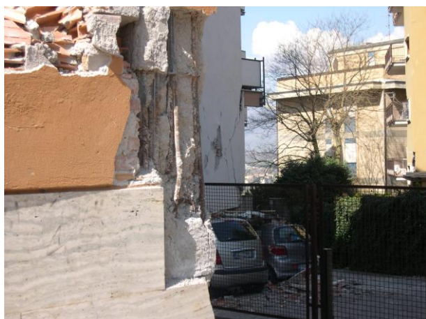
Figura 13. Insufficiente armatura trasversale.
