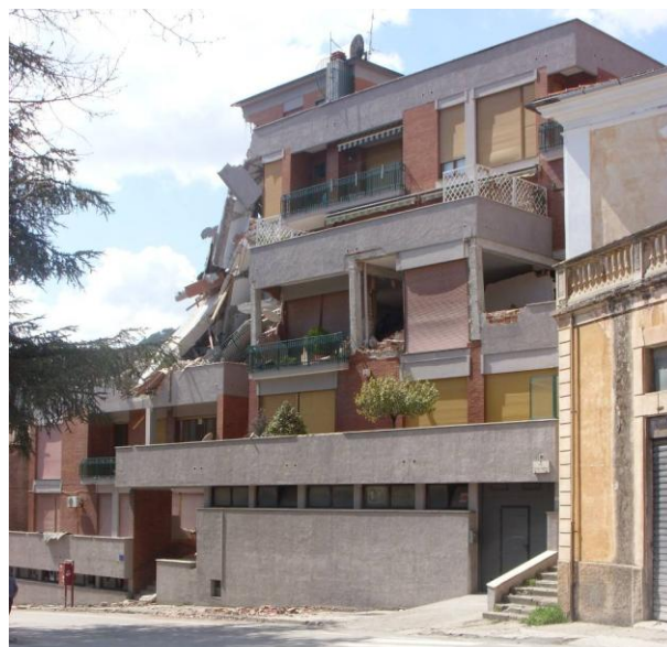
Figura 15. Edificio irregolare a L'Aquila. Vista dopo la scossa del 6 Aprile.
